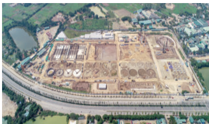
Công trình nhà máy xử lý nước thải bị ngập nước
