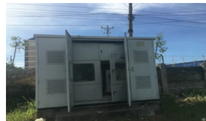
Sự cố tổn thất trạm biến áp 560KVA
