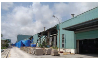
Tổn thất Nhà xưởng và Máy móc thiết bị
