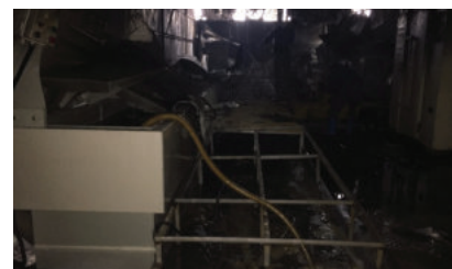
Tổn thất cháy Nhà xưởng, Máy móc thiết bị, dây chuyền mạ
