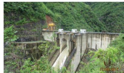
Tổn thất Thiết bị cơ khí thủy công, Thiết bị điện nhà máy và Lưới chắn rác do bão
