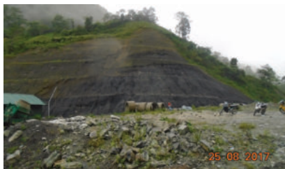
Tổn thất sạt lở Taluy dương Công trình đường Quốc lộ
