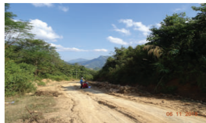
Tổn thất sự cố sạt lở, nền, mặt đường
