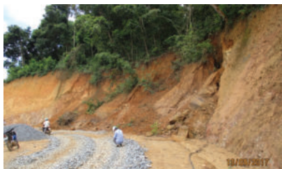
Tổn thất sạt lở Mái ta luy và Cổng thoát nước
